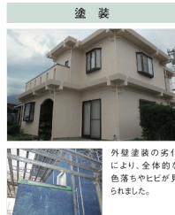
海岸付近の建物だったこともあり、強風による被害が全体に劣化が進んでいました。
